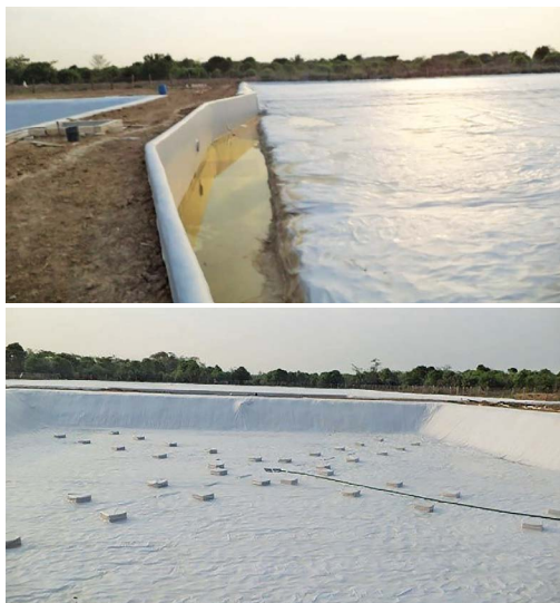
Figura 3. Área de captación de agua de lluvia (izquierda) y Olla de almacenamiento recubierta con geomembrana (derecha).
