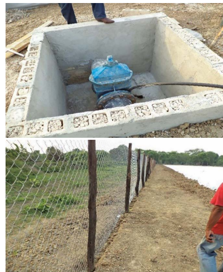
Figura 4. Válvula de paso hacia el depósito (izquierda) y Cerco perimetral de la cuenca de captación (derecha).
